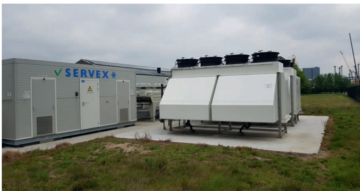
De installatie bij kuikenbroederij Van Hulst.
