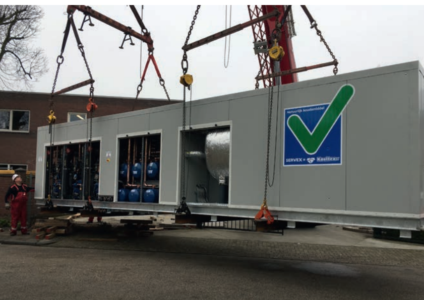
De installatie bij Van Hulst is ruim een jaar geleden geplaatst.
