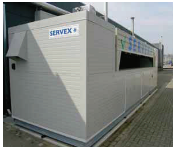
Buitenopstelling van een R290/R744-koelinstallatie met ingebouwde condensor voor de koeling van vleeswaren.
