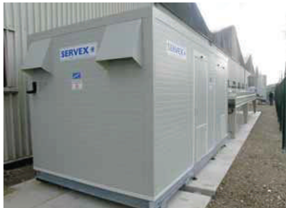
Buitenopstelling van een R290-koelinstallatie en condensor voor de koeling van champignons.
