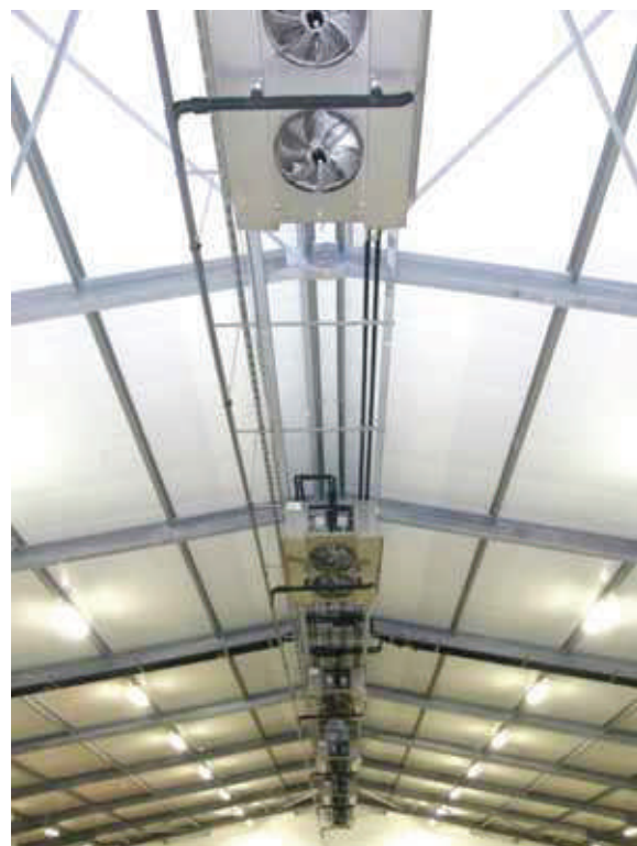
Dubbelzijdig uitblazende verdampers, aangesloten op het CO 2 -systeem in de koelcel voor eieren.
