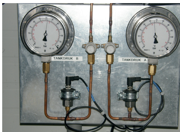
Tankdrukken bij multi-purpose thermisch pompsysteem.
