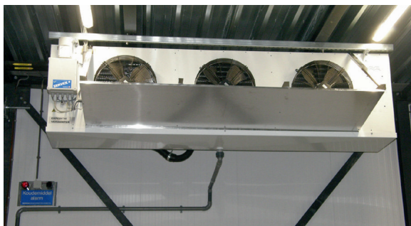
Koeler in koelcel met alarmeringsysteem.
