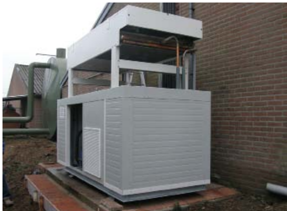
Buiten opgestelde koelinstallatie met propaan als koudemiddel voor de opslag van aardbeien.
